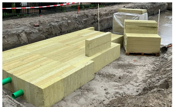
Rockflow Rigole unter begrüntem Parkplatz
