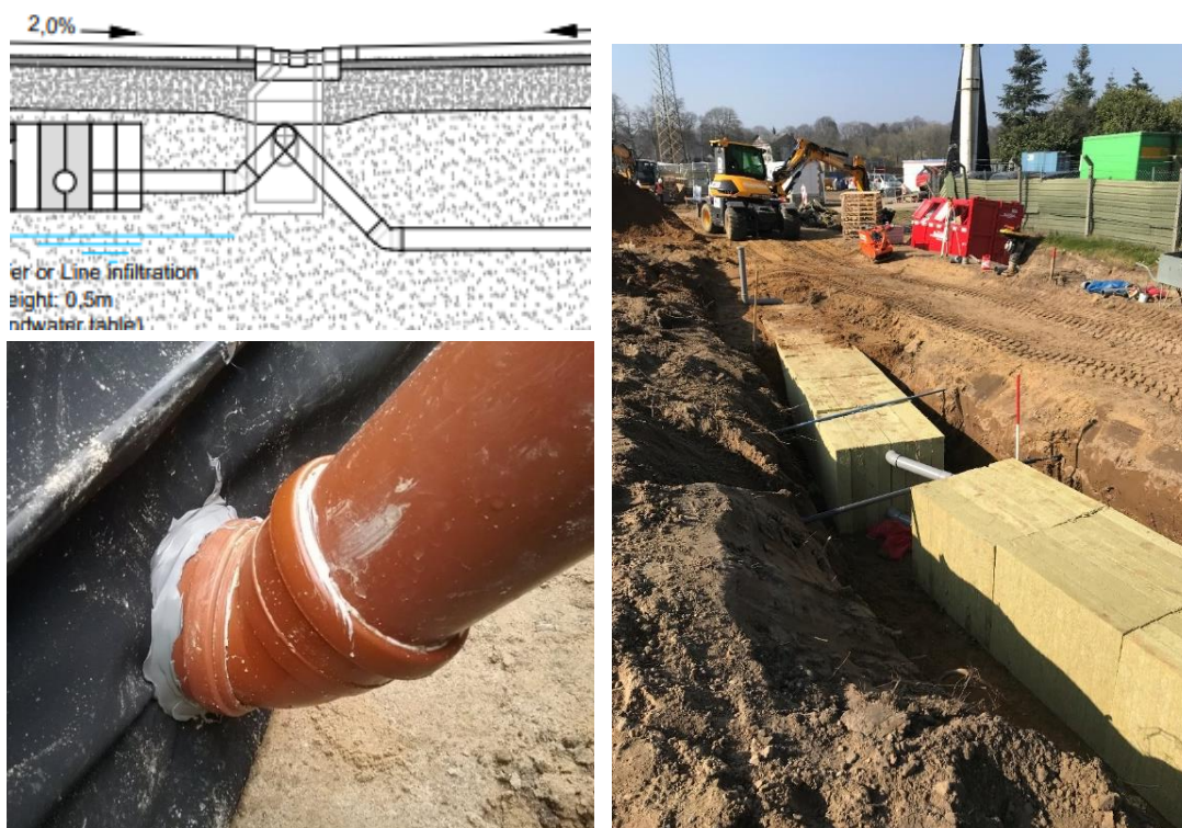
Figur 6: På skitsetegningen (øverst tv), ses eksempel på rørføring med max 45^\circ bøjninger mellem Rockflow anlæg og brønd. Eksempel herpå ses også på fotos nederst tv og th.
