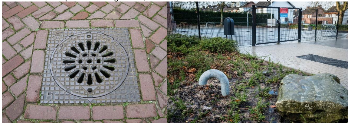
Figur 16: Udluftningen kan ske via. Et særskilt dæksel med åbent dæksel (se foto tv.), svanehals eller som tilslutning i en rendestensbrønd (se foto th).
