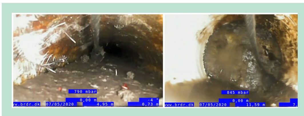
FIGUR 17. Tv. TV-inspektion af kanal 1 i filteret under Risvang Allé inden spuling. Kameraet er ca. 1 m inde i kanalen, som her er fyldt ca. halvt op med slam. Længere inde forventes mere slam, da dette bliver skubbet ind i kanalerne. Th. Indløbskanalen ca. 8 meter inde i filteret. Efter spuling er kanalen helt tømt for slam, og tilbage ligger kun lidt vand, som vil sive ud i filteret.
