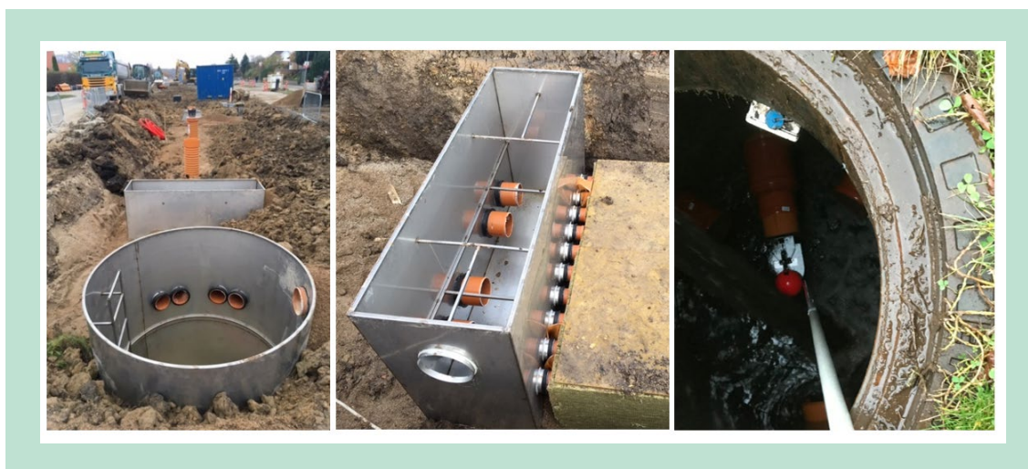
FIGUR 5. Etableringen af filterløsningen på Risvang Allé i Aarhus. Fra venstre ses a) sandfangsbrønd med indløb til manifold efterfulgt af tre sensorbrønde og udløbsbrønd, b) indløbsmanifolden, som leder vandet fra sandfangsbrønd og videre ind i filteret og evt. overløbsledning, c) udløbsrør med kontraklap.
