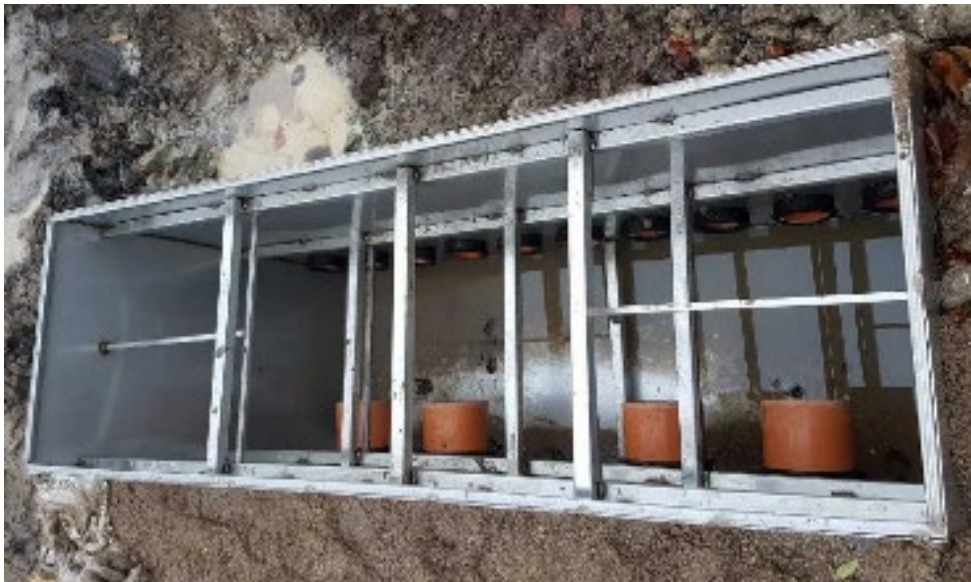
Indløbsmanifold med fire indløbsrør fra indløbsbrønden og 10 filterindgangsrør.
