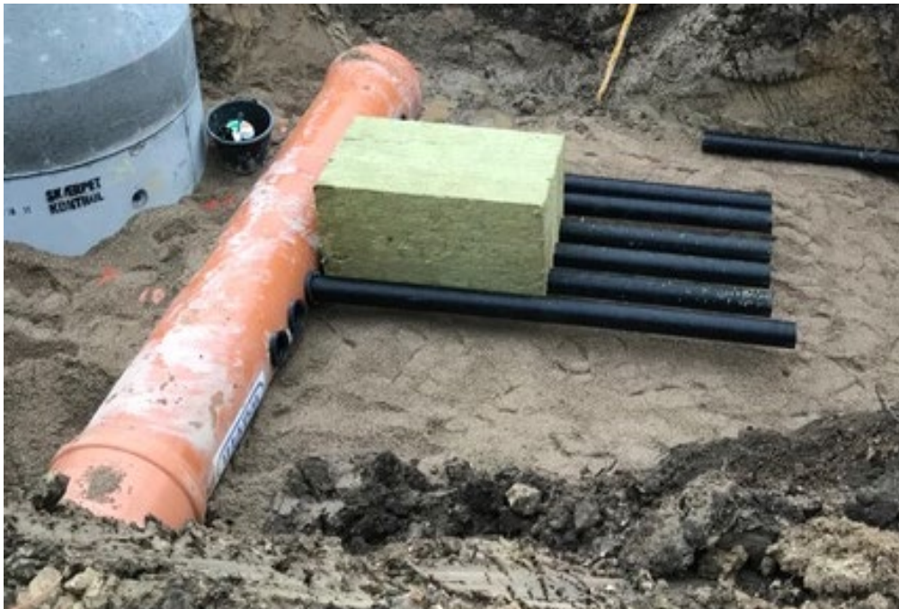
Udløbsmanifold med tilkoblede drænrør
